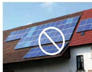
Les panneaux solaires sont souvent mal intégrés sur la toiture
