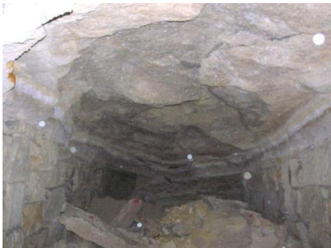
Photo 10 : début de fontis sous le techni-centre à Châtillon (photo SNCF)
