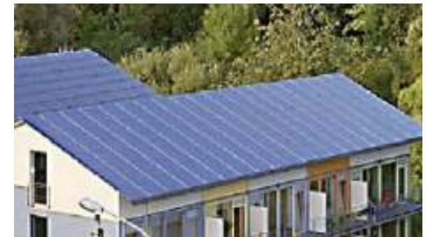
Intégration des panneaux photovoltaïques : Ici la totalité du toit est constituée ici de panneaux solaires
