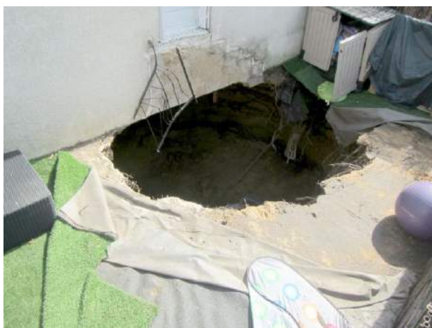
Photo 11 : fontis venu à la surface sous un bâtiment en 2018 (photo SVM) 20 rue de Fontenay
