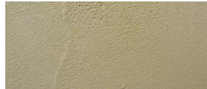
L'enduit ciment cause de désordres importants est à proscrire sur les maçonneries traditionnelles en moellons de pierre
