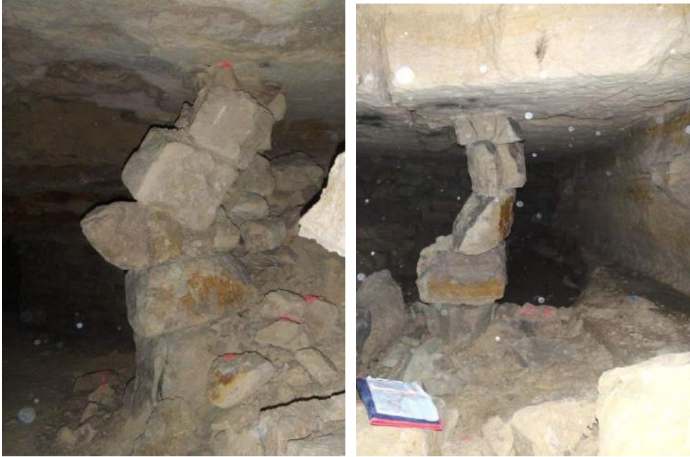
Photo 13 : exemples de tassement général d'une carrière entraînant la dégradation des piliers à bras – techni-centre (photo AML-IGC)
