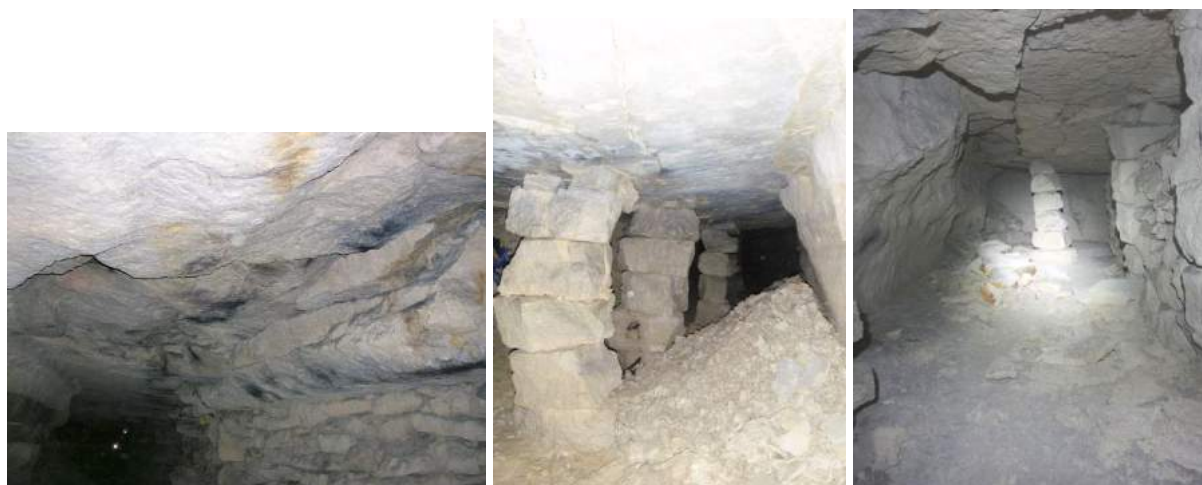
Photo 12 : exemples de cassure du toit en front de taille - sous le technicentre SNCF et la rue de Paris à Châtillon (photo AML et JQ - IGC)
