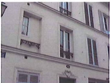
Hétérogénéité des menuiseries
